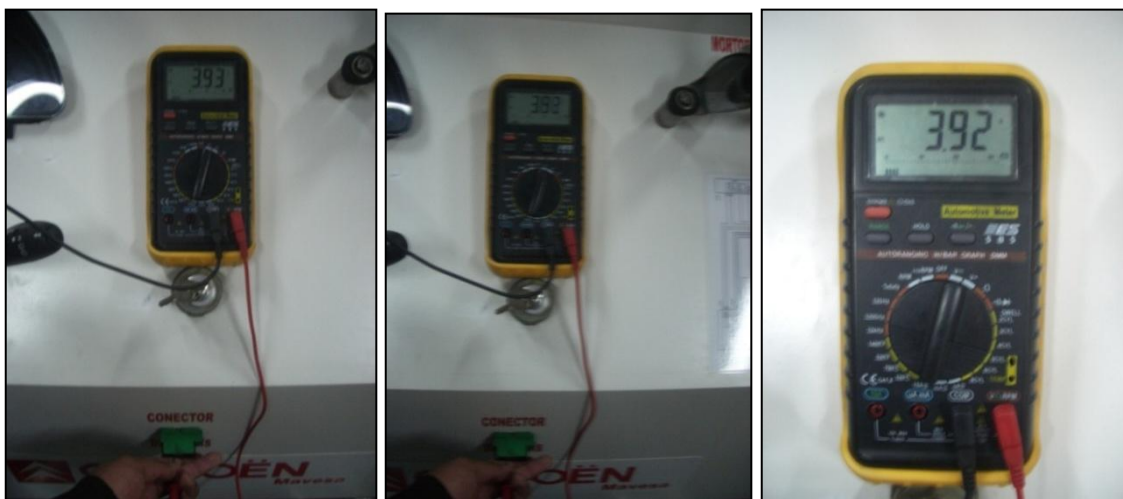
Figura 4.35.- Pin 14 del conector 16V NR de la toma de diagnosis.
