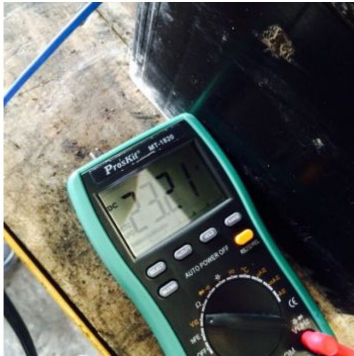
Figura 21. Voltaje de salida del generador
