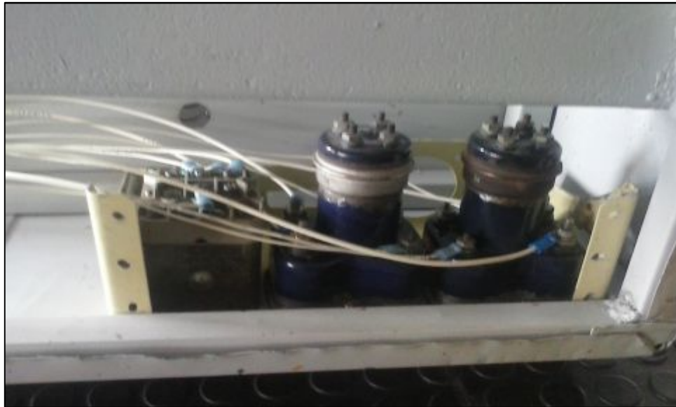
Figura 42. Relés instalados en el banco
