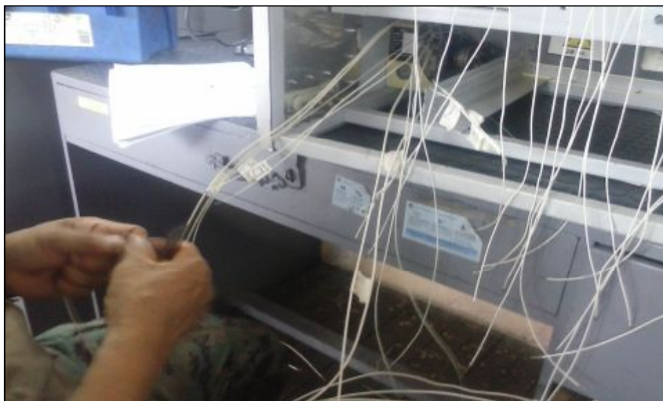
Figura 47. Señalización de conductores
