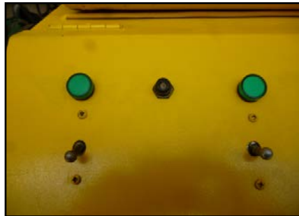
Figura 83. Circuit breaker e interruptores en posición OFF
