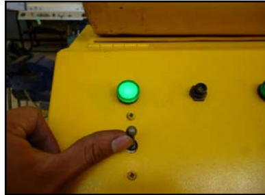
Figura 86. Interruptor de paso de corriente en posición ON
