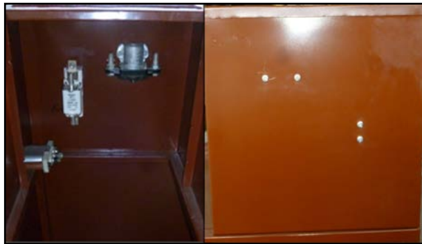
Figura 72. Dispositivos eléctricos fijados al banco de prueba
