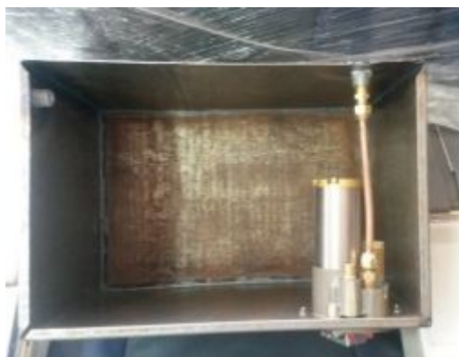
Figura 32 Ajuste de cañería de la Bomba Booster con el reservorio
