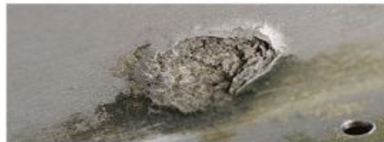
FIGURA 19: CORROSIÓN POR EXFOLIACIÓN
