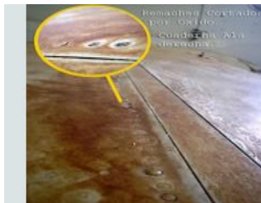
FIGURA 15: ÓXIDO EN SUPERFICIES DE METAL
