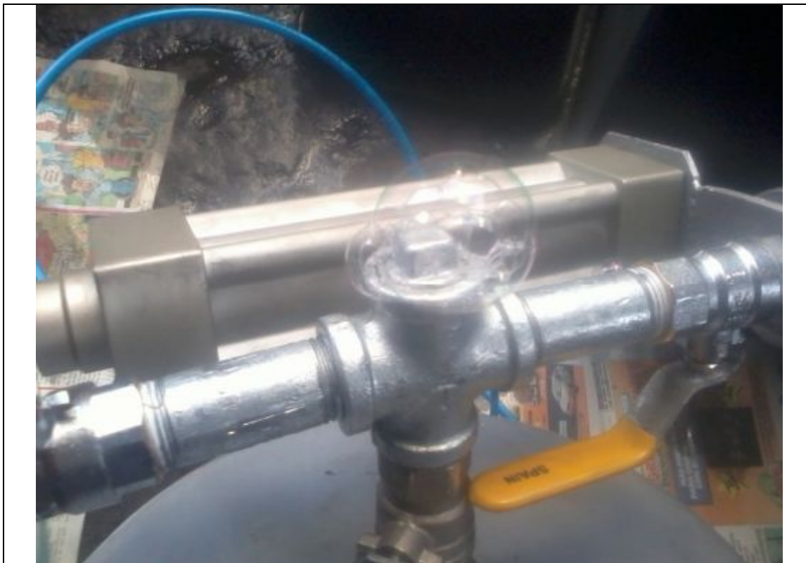
FIGURA 45: PRUEBA DE FUNCIONAMIENTO
