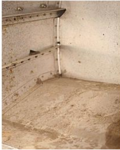
FIGURA 13: ÁREA DE BATERÍAS
