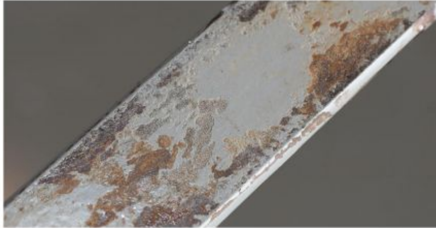
FIGURA 22: CORROSIÓN POR DESGASTE
