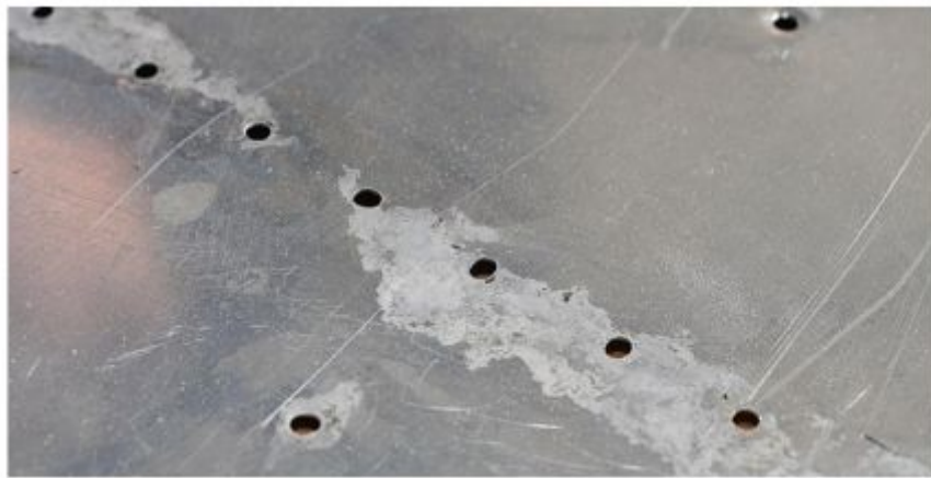
FIGURA 16: CORROSIÓN SUPERFICIAL UNIFORME
