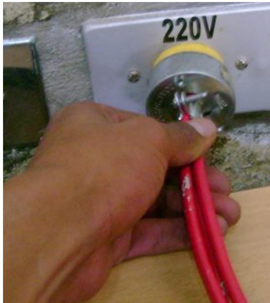
Figura 4.17 Cable de conexión del compresor a 220 voltios.
