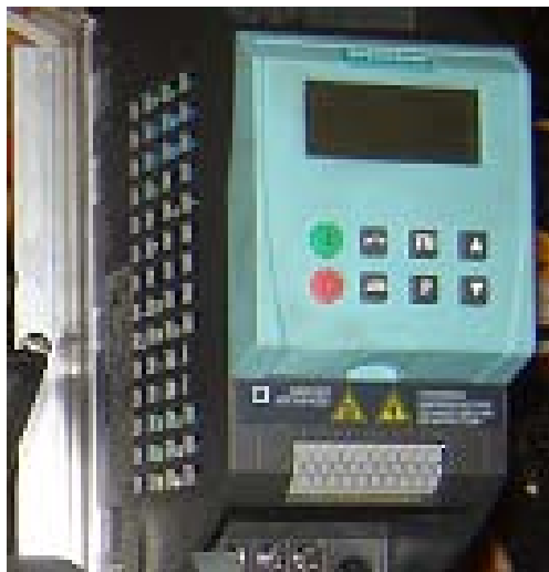
Fig. N° 5.14.- Variador de frecuencia
