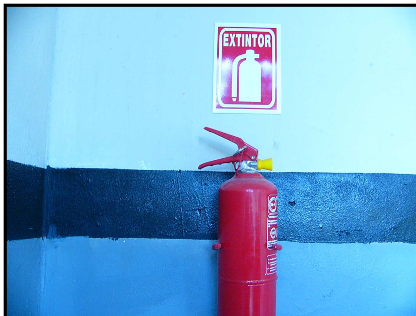
Foto 6.7 Extintor Fuente: Taller de mecánica básica Realizado por: Cbos. Téc. Avc. Cadena David
