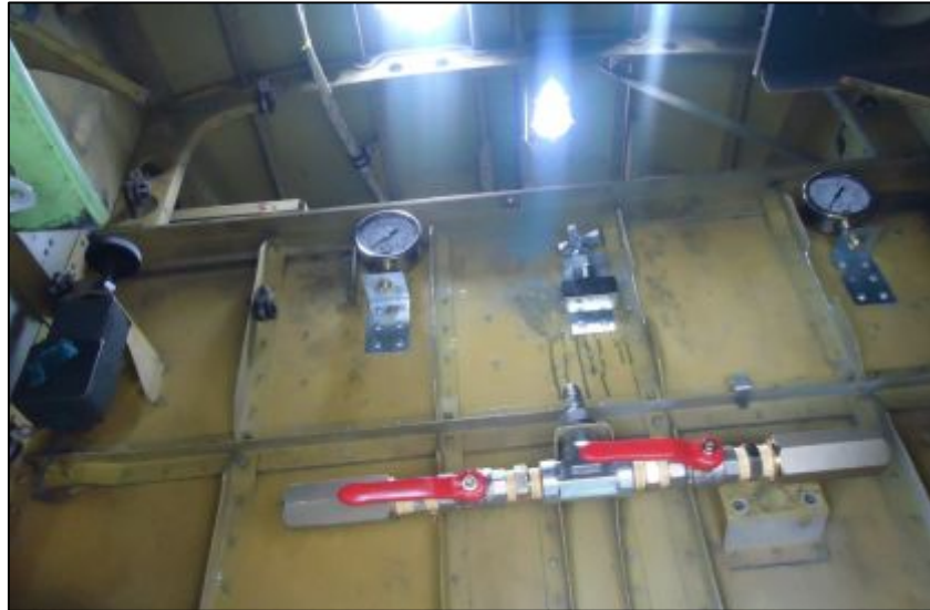
Figura 80: Componentes hidráulicos instalados
