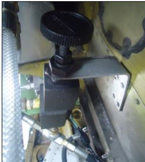
Figura 68: Válvula de alivio instalada
