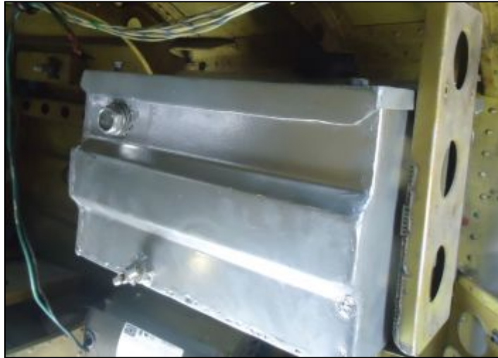
Figura 67: Reservorio Hidráulico instalado
