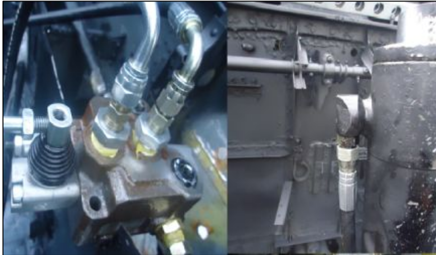
Figura 82: Cañerías de mando y actuador hidráulico
