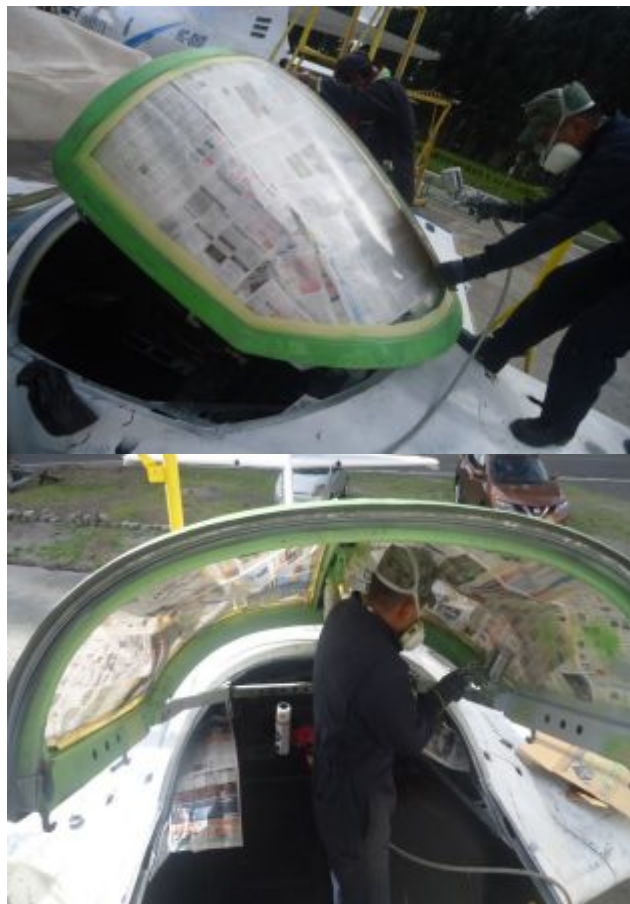
Figura 91: Aplicación de primer
