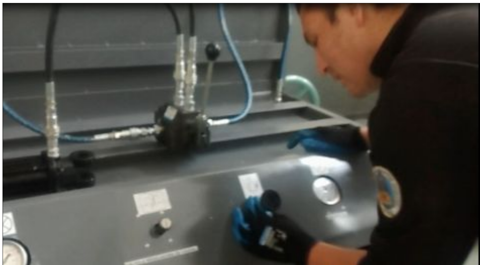
Figura 106 Verificación del sistema con actuador.
