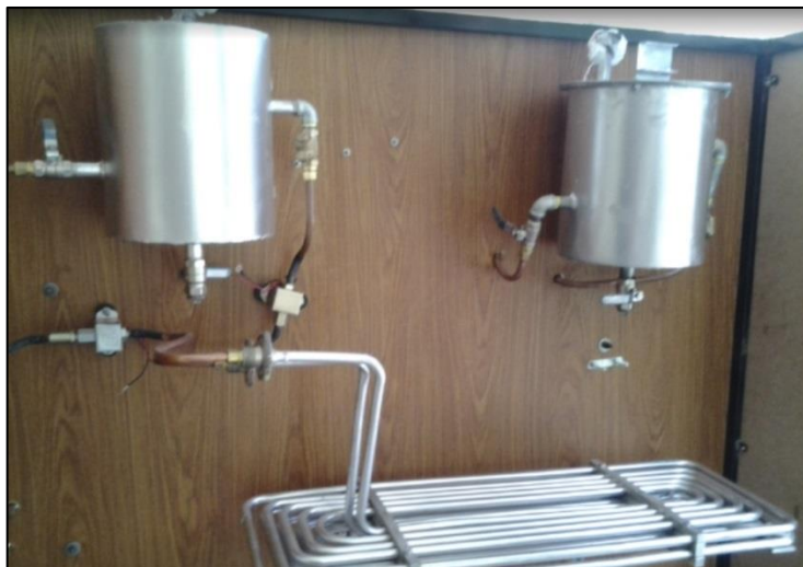
Figura 3.25 Instalación de reservorios, serpentín y bombas
