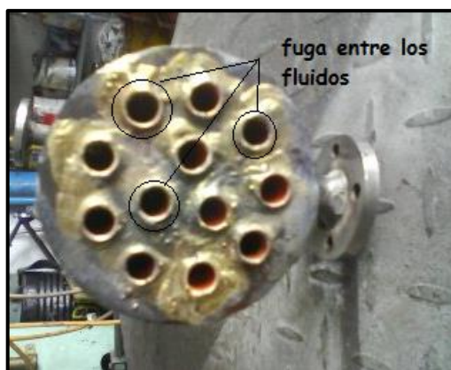
Figura 3.29 Fugas encontradas en el intercambiador
