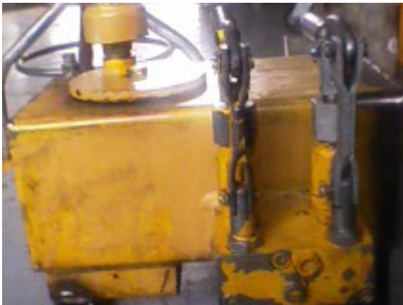
Figura 5.32: Bomba sujeta al reservorio.
