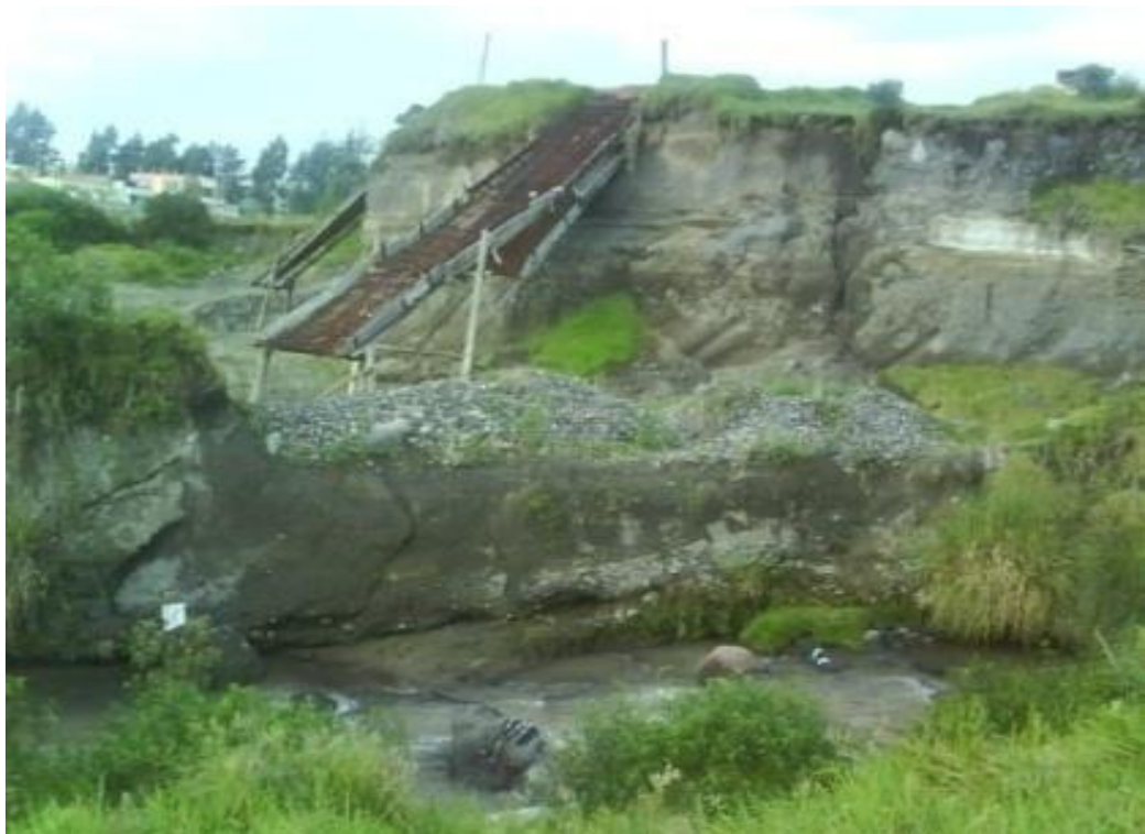
Fig. B.3 Mina explotada de manera anti-técnica
