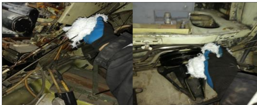
Figura 51 Limpieza de cables de control del rudder
