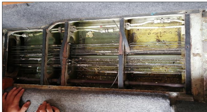
Figura 64 Paneles de acceso del elevador libres
