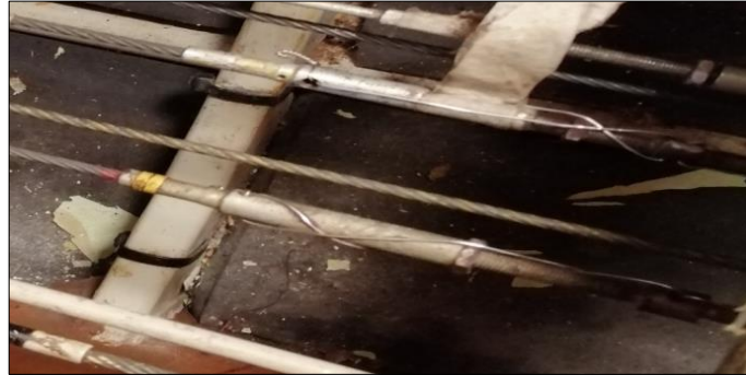
Figura 69 Turnbuckles del elevador seguros
