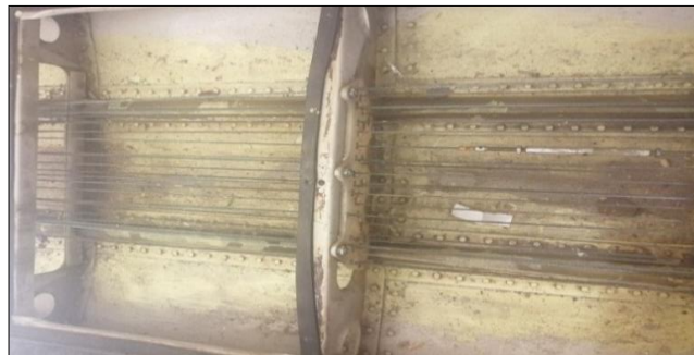
Figura 22 Cables de control
