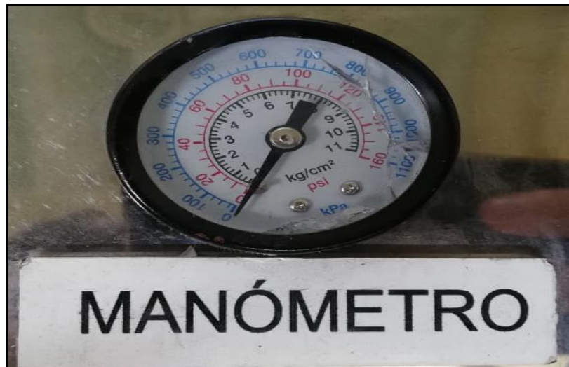
Figura 41 Manómetro del tablero de control
