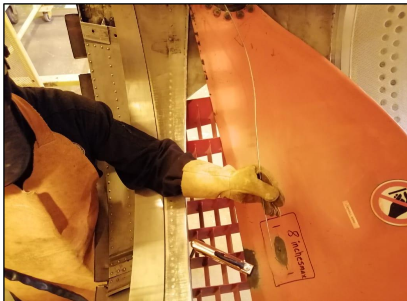
Figura 29 Rajadura rellenada con material de aporte ER308L
