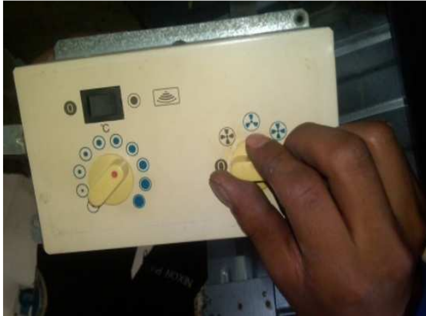
Figura 3.2: Panel de controles del aire acondicionado domestico
