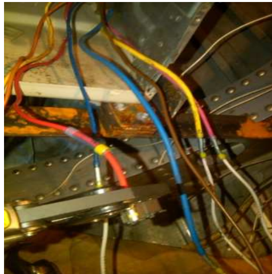
Figura 3.9: Uniones frías de los cables a el sistema en el avión
