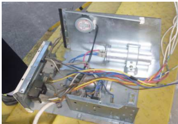
Figura 3.21: Caja de control del aire acondicionado
