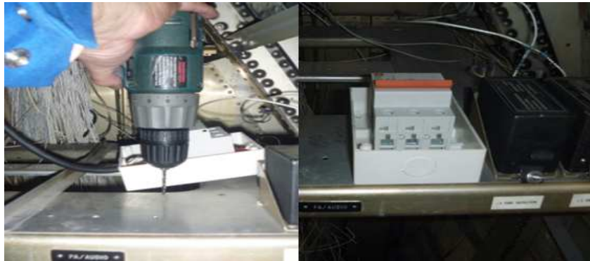
Figura 3.19: Breaker de seguridad en la estación 047 del avión fairchild
