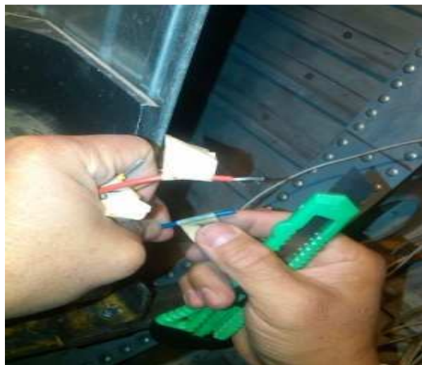
Figura 3.7: Enumeración del cables
