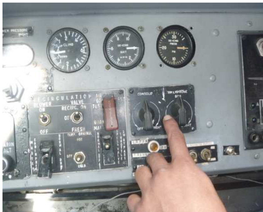
Figura 3.1: Panel de instrumentos del sistema de aire acondicionado
