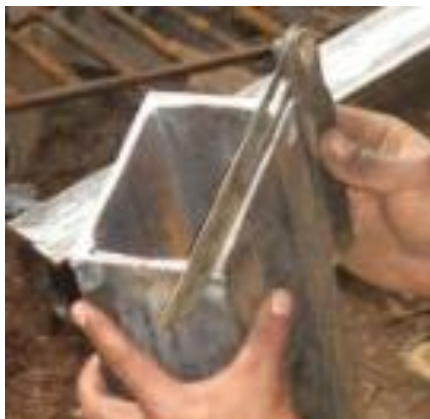
Figura 4.21. Verificación de medidas
