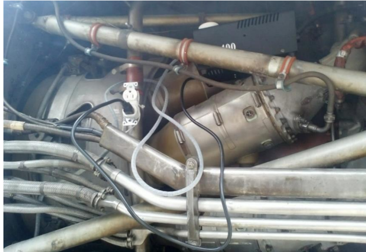
Figura 3.32: Toma corriente de 110 voltios en el motor derecho
