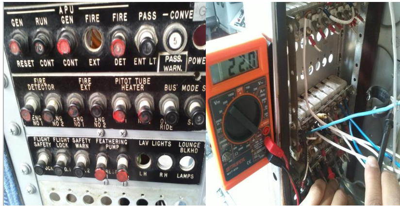
Figura 3.25: Verificaron de los circuit breakers cerrados
