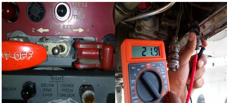
Figura 3.28: Continuidad eléctrica de los plugs extintores N°2
