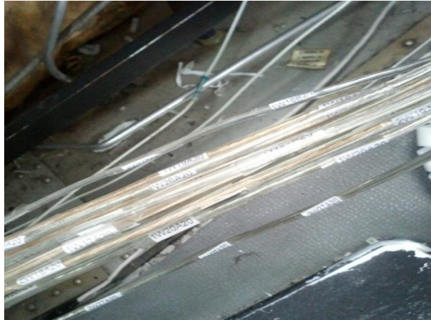
Figura 3.14: Identificación del Cableado.
