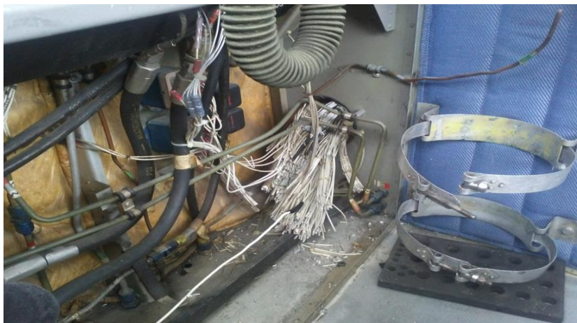
Figura 3.7: Cables cortados de cabina parte trasera
