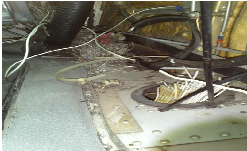
Figura 3.6: Cables cortados en cabina
