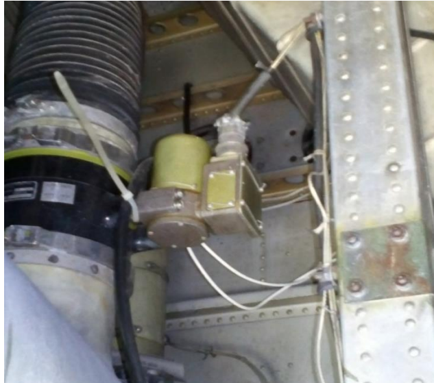
Figura 3.17: Empalme en la fuente de poder de 110 voltios.
