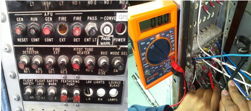
Figura 3.23: Verificación de los circuit breaker abiertas
