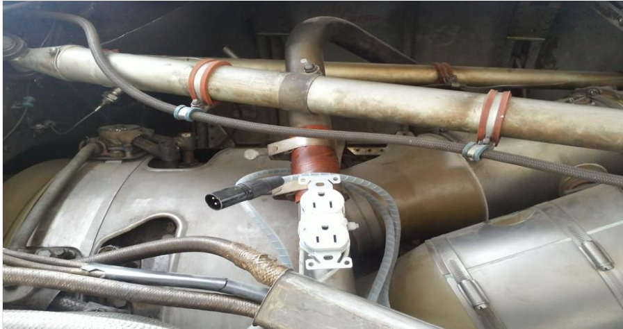
Figura 3.30: Toma corriente de 110 voltios en el motor derecho
