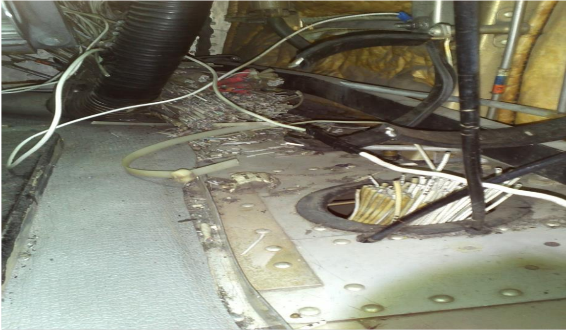
Figura 3.5: Cables cortados en cabina
