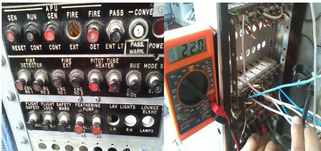
Figura 3.24: Verificación de los circuit breaker cerrados
