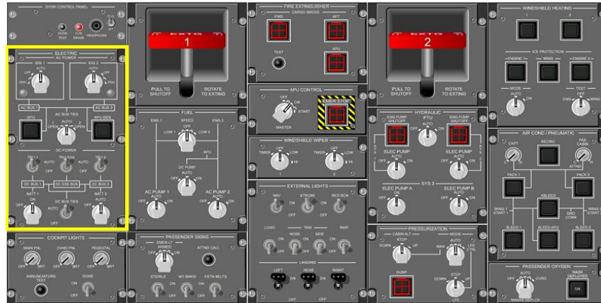
Figura 2.43. Panel de Control Eléctrico Remarcado Fuente: Manual Embraer 170/190 Power Up and Power Down Procedures
