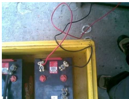
Figura 3. 67. Baterías y cables de alta. Fuente: Investigación de campo. Editado por: Omar Flores
