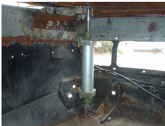
Figura 4.19. Cilindros neumáticos instalados.
