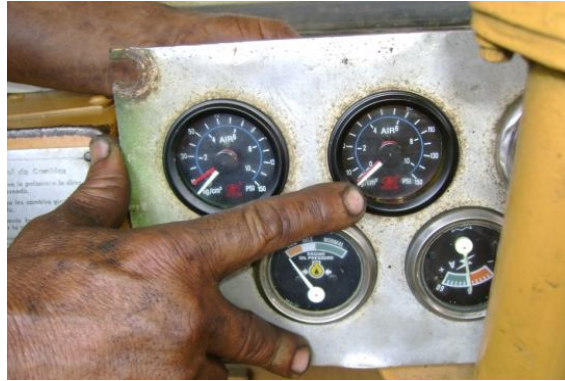
Figura 4.26 Colocación de los manómetros
