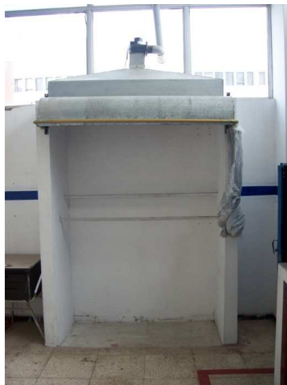
Fig. 2.2. Cabina de pintura en mal estado
