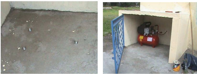
Fig. 3.19 Empotramiento del compresor
