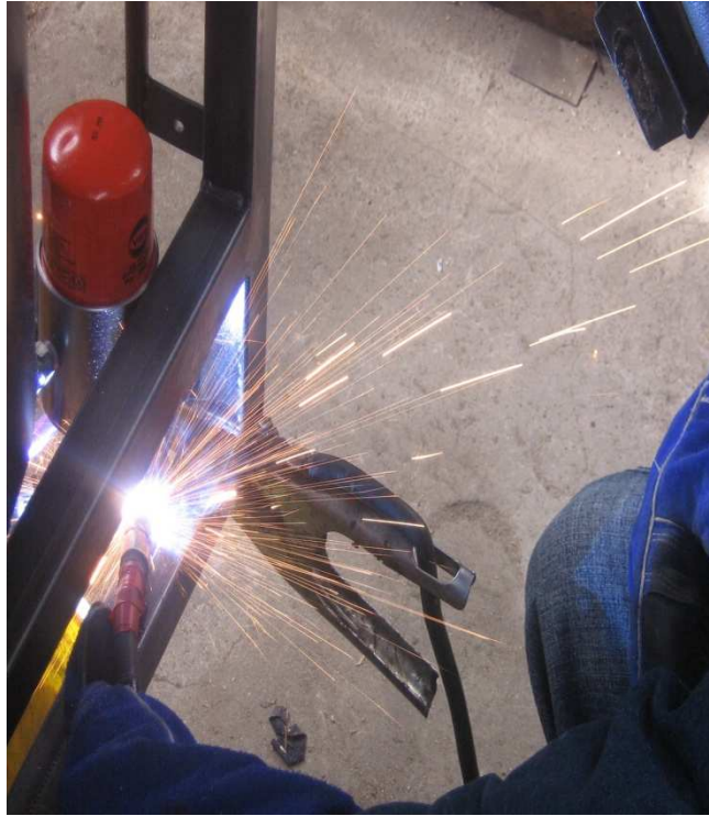
Fig.7 Soldando la platina a la estructura y soldando el cilindro del filtro Realizado por: David Díaz Investigación: De campo
