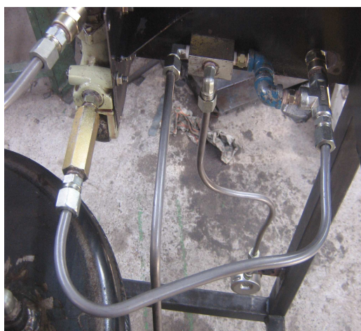
Fig. 3.14 Cañería rígida TN095063 Realizado por: David Díaz Investigación: De campo
