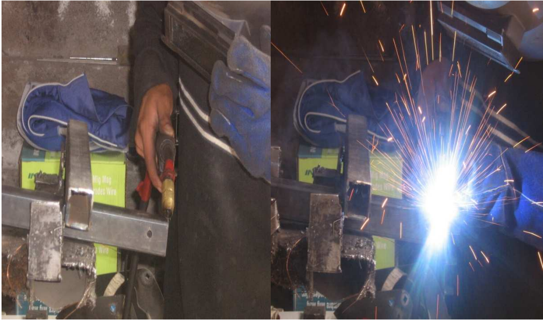
Fig.3 Soldando Tubo cuadrado de hierro reforzado de 40x40mm, para la formación de la estructura Realizado por: David Díaz Investigación: De campo
