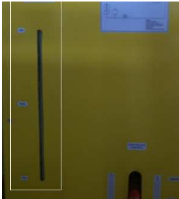
Fig.4 Zona de verificación del nivel hidráulico del depósito de almacenamiento
