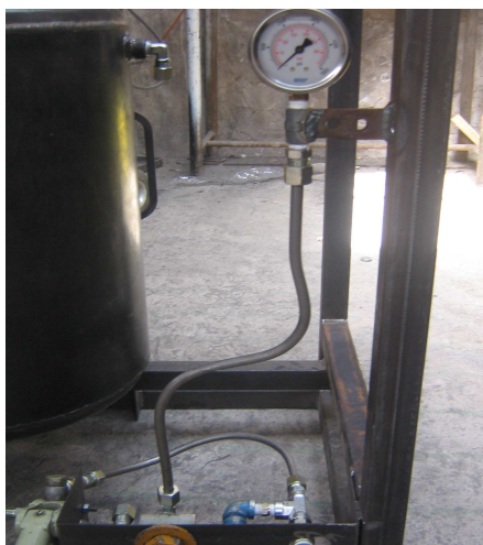
Fig. 3.15 Cañería rígida TN095063 Realizado por: David Díaz Investigación: De campo
