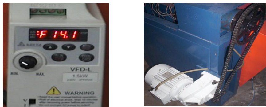
Figura 3.10.- Variador de frecuencia y motor eléctrico.
