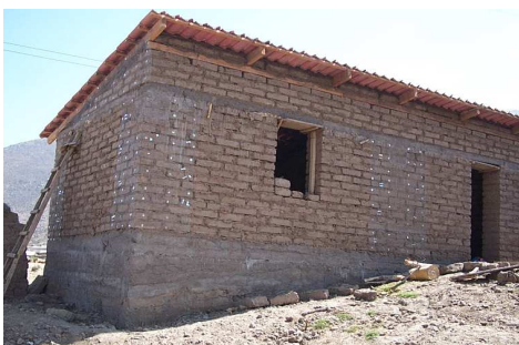
Fig.39. Vivienda en Construcción. Nótese la solera de concreto con dientes en los extremos y la malla.
