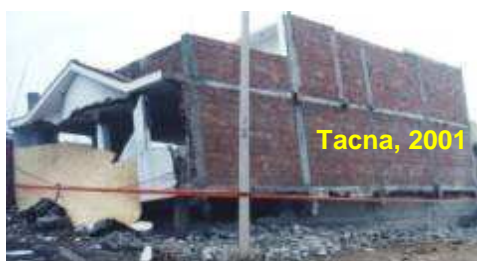
Fig.26. Colapso de una vivienda con baja densidad de muros en la dirección de la fachada. Nótese que los muros largos no contribuyen a la resistencia en la dirección transversal.
