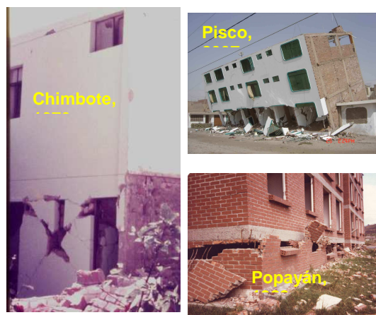
Fig.15. Falla por corte en el primer piso de la edificación ante sismos reales.
