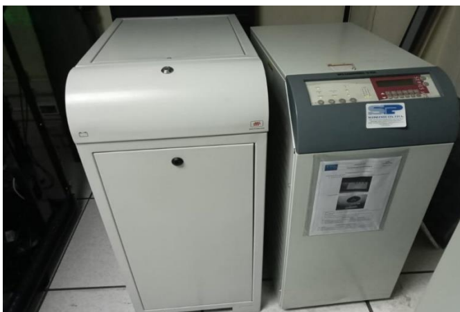
Sistema de Fuerza Interrumpible (UPS)
