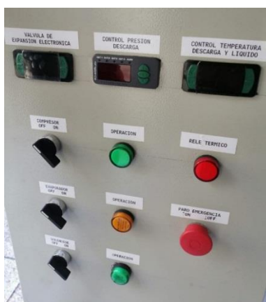
Figura 27. Tablero de control
