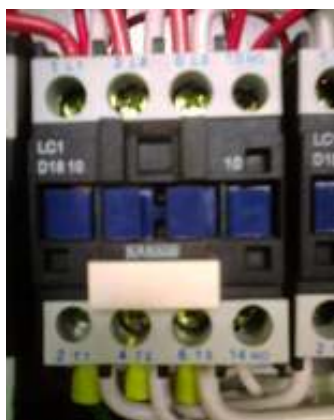
Fig. 4.24 Segundo relé de control de salida al motor
