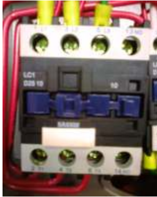
Fig. 4.22 Primer relé de entrada de corriente trifásica
