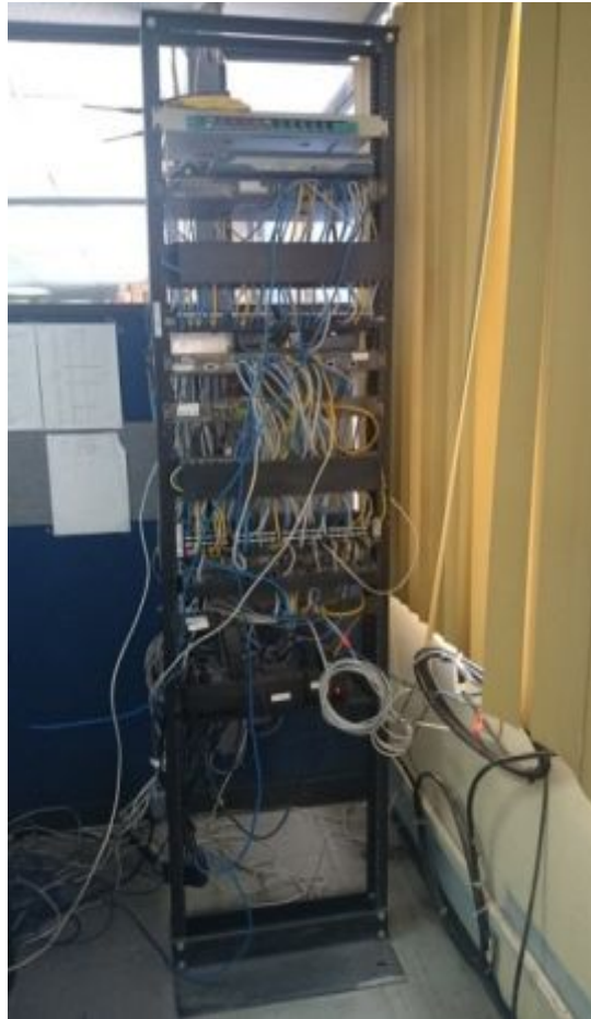
Figura 43. Rack de piso
