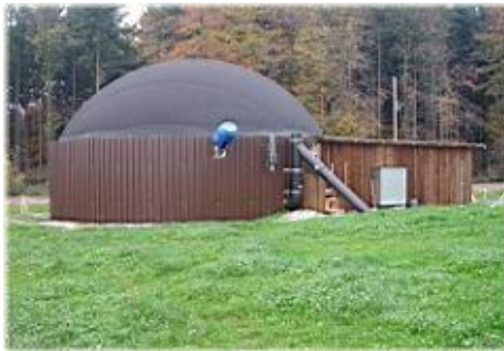
Figura 4.5: Digestor Con Tanque de Almacenamiento Tradicional y Cúpula de Polietileno. 71
