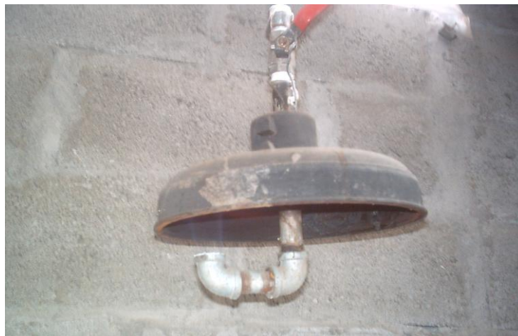
Fotografía 6.44: Toma de Salida de Biogás a un Calentador
