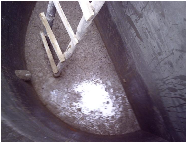
Fotografía 6.29: Ambiente Húmedo en el Interior del Biodigestor.
