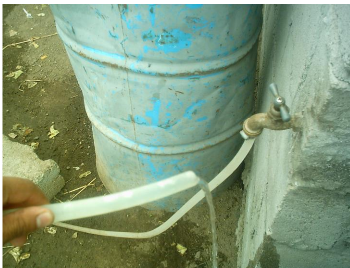
Fotografía 6.3: Manguera de Toma de Agua.
