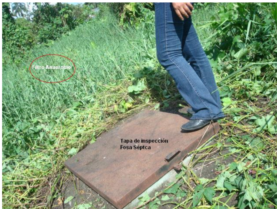
Figura 3.5. : Planta de Tratamiento, tanque de filtro ascendente.
