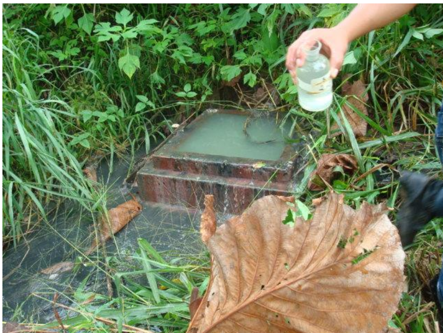
Figura 3.8.: Pozo de revisión colapsado.
