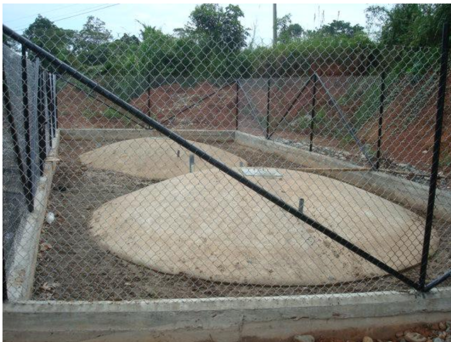
Figura 3.10.: Planta de Tratamiento del Barrio La Pampa en verano
