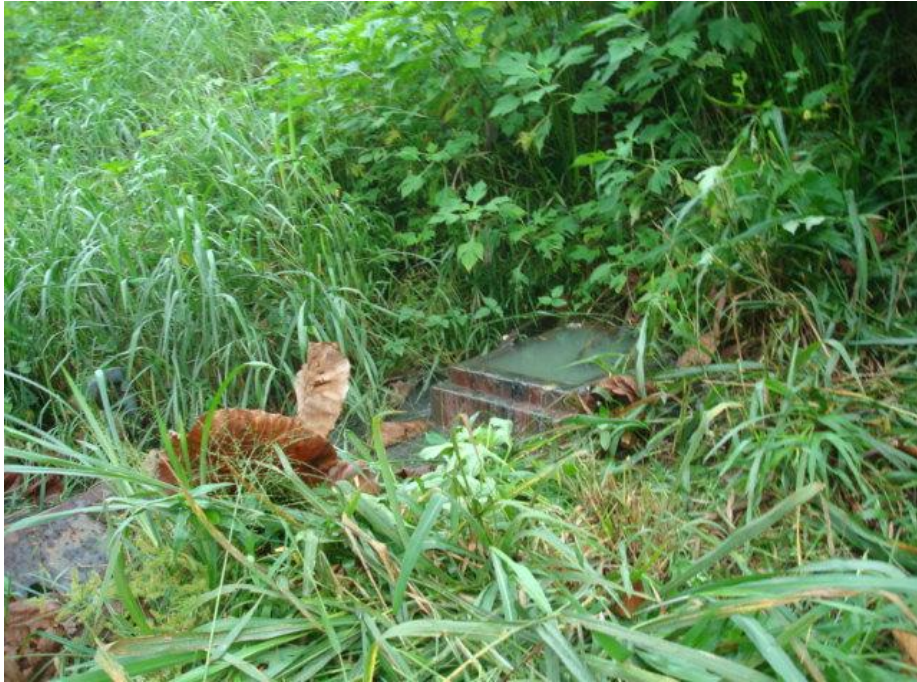
Figura 3.17.: Excesiva vegetación en las PTAS
