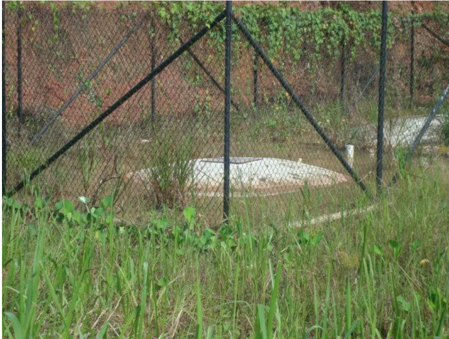
Planta de Tratamiento Aguas Residuales Barrio La Pampa
