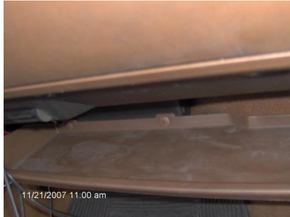
Figura 3.37 Lugar y espacio para la colocación del modulo de control
