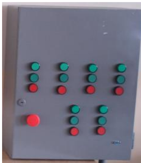
Figura 5.12 Dispositivos de mando y control del panel frontal de la máquina
