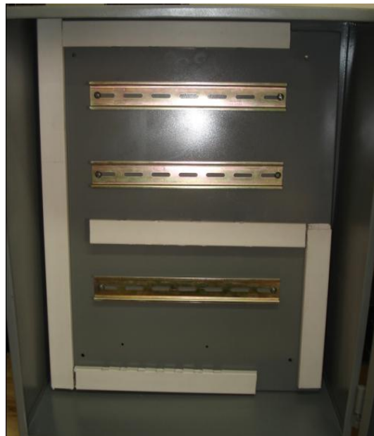
Figura 5.13 Vista interior de canaletas plásticas para cableado
