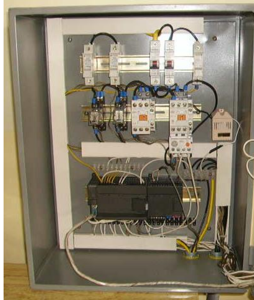
Figura 5.11 Vista interior de los componentes de control
