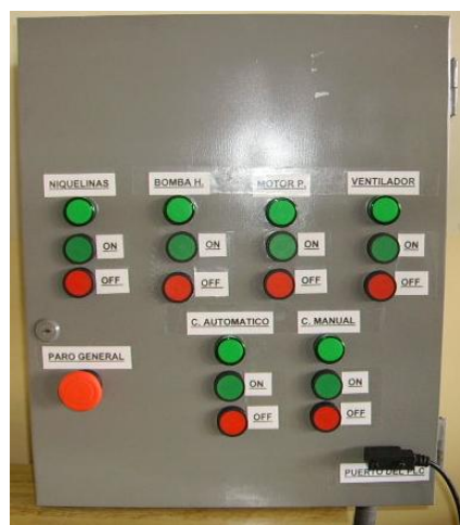
Figura 5.8 Vista general del tablero de control
