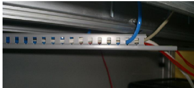
Figura 2.39 Cableado eléctrico del proceso
