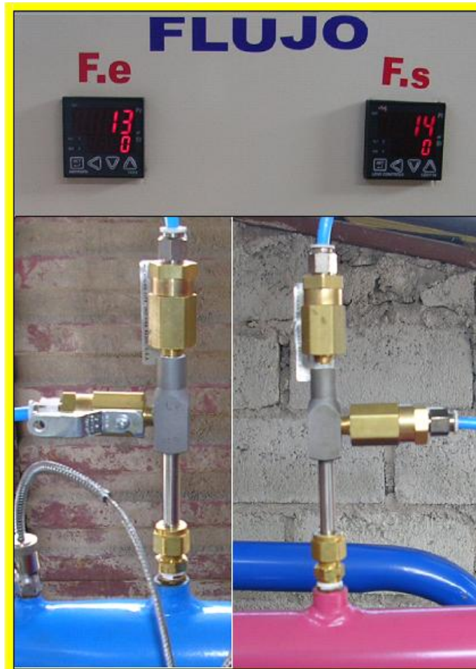
Figura 4.22. Prueba de los sensores de flujo
