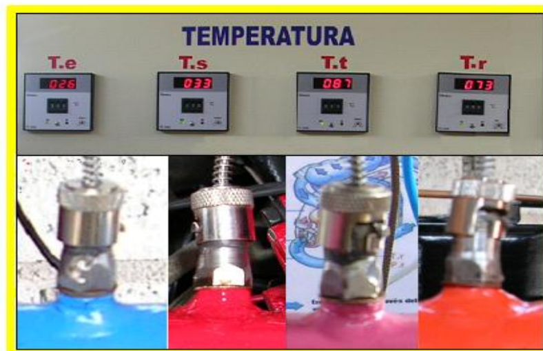
Figura 4.14. Prueba de los controles de temperatura
