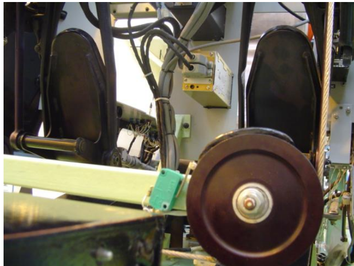
Fig. 4.6 Finales de carrera en el sistema de poleas de los pedales de dirección
