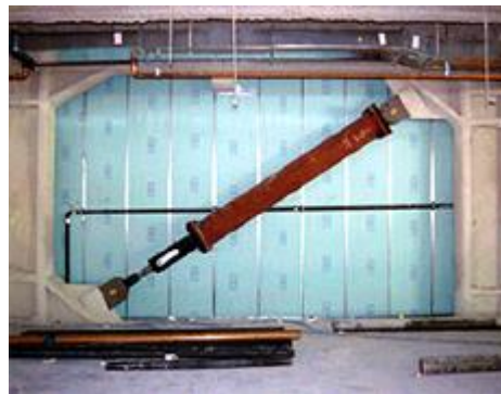
Figura 2.10. Amortiguador viscoso instalado en la estructura
