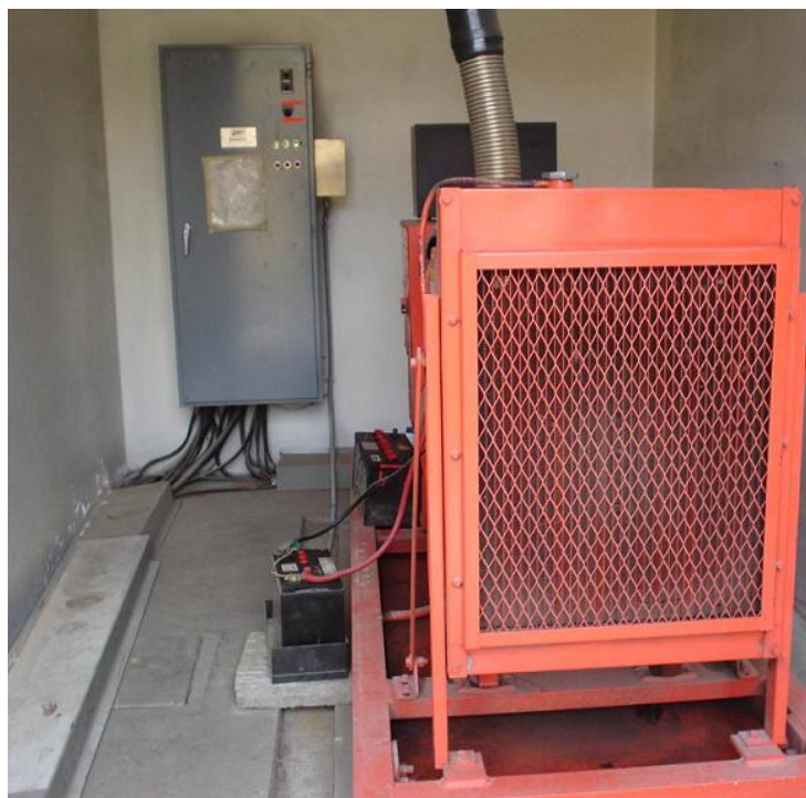
Figura 2.2 Sistema de transferencia, grupo generador y tablero de transferencia
