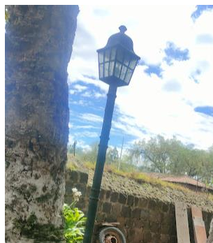
Nota. Sistema de iluminación
