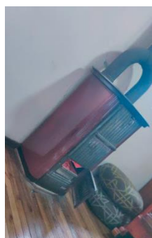
Nota. Calefacción natural área de recibimiento
