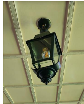
Nota. Sistema de iluminación
