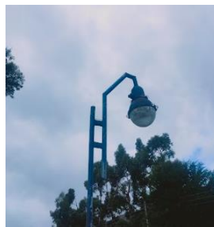
Nota. Iluminación área estacionamiento
