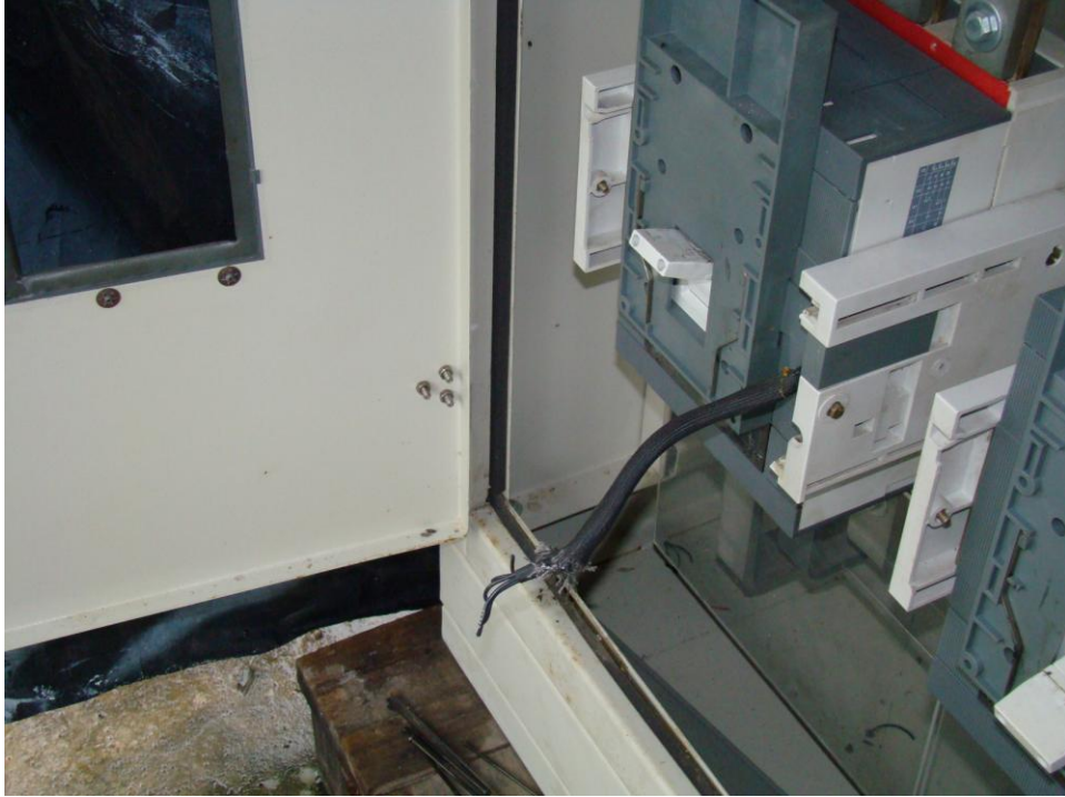
Fotografía 7.- Cableado de Circuit Breakers
