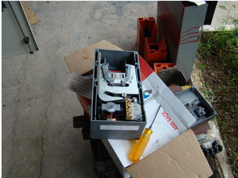
Fotografía 1.- Parte posterior del Circuit Breakers
