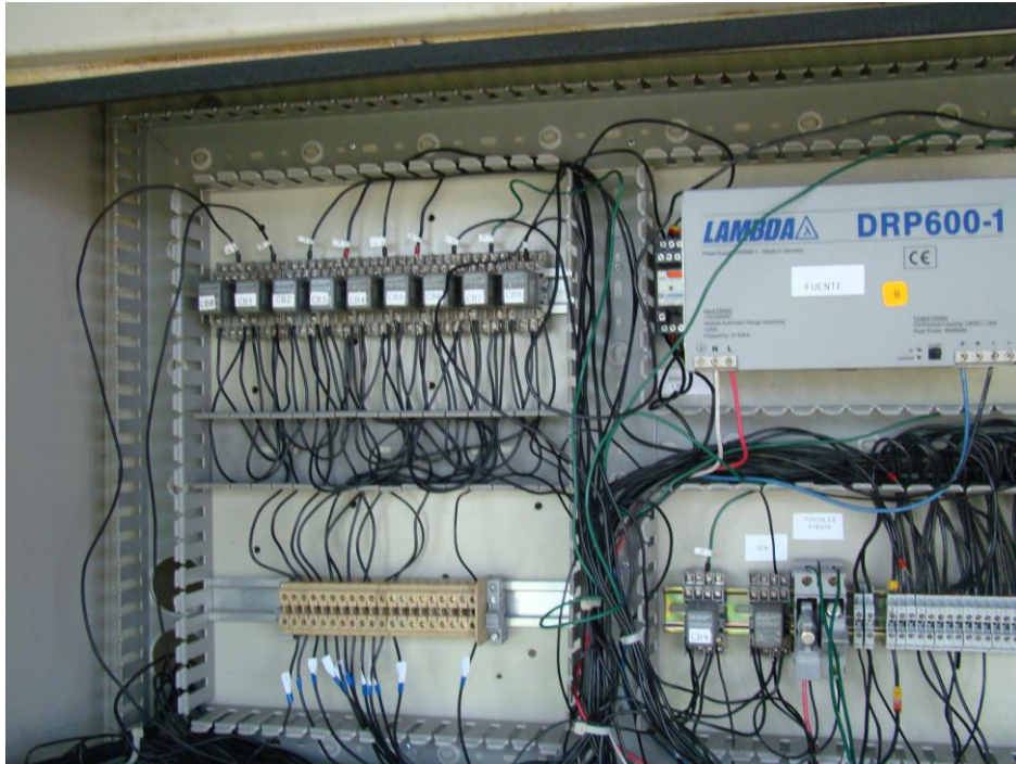
Fotografía 5.- Cableado de CBs
