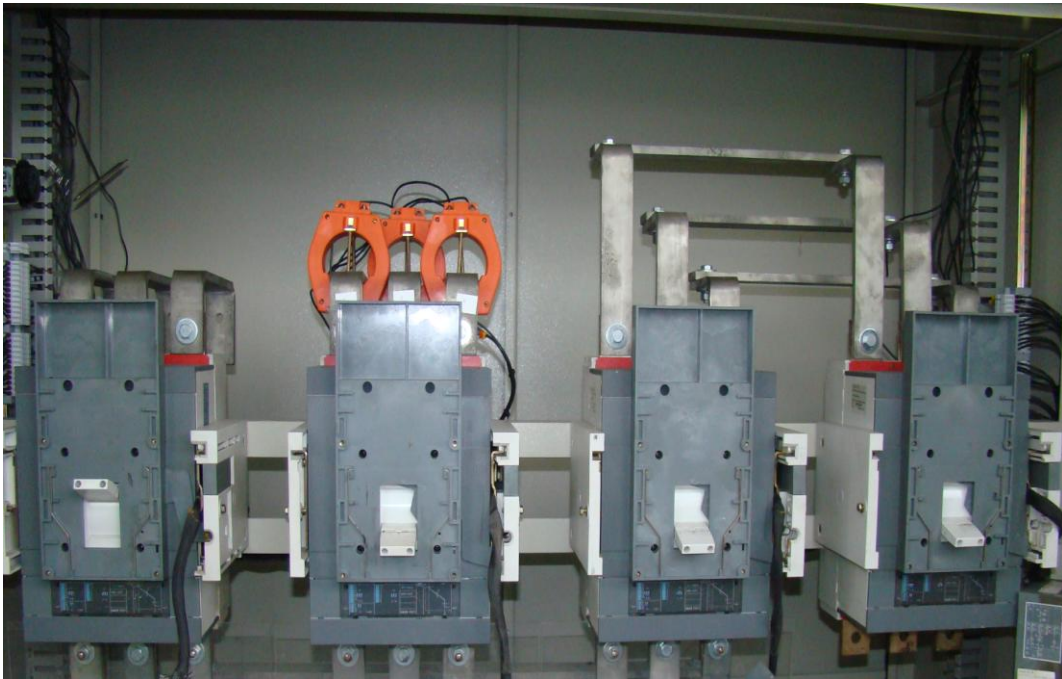
Fotografía 8.- Bases de Circuit Breakers
