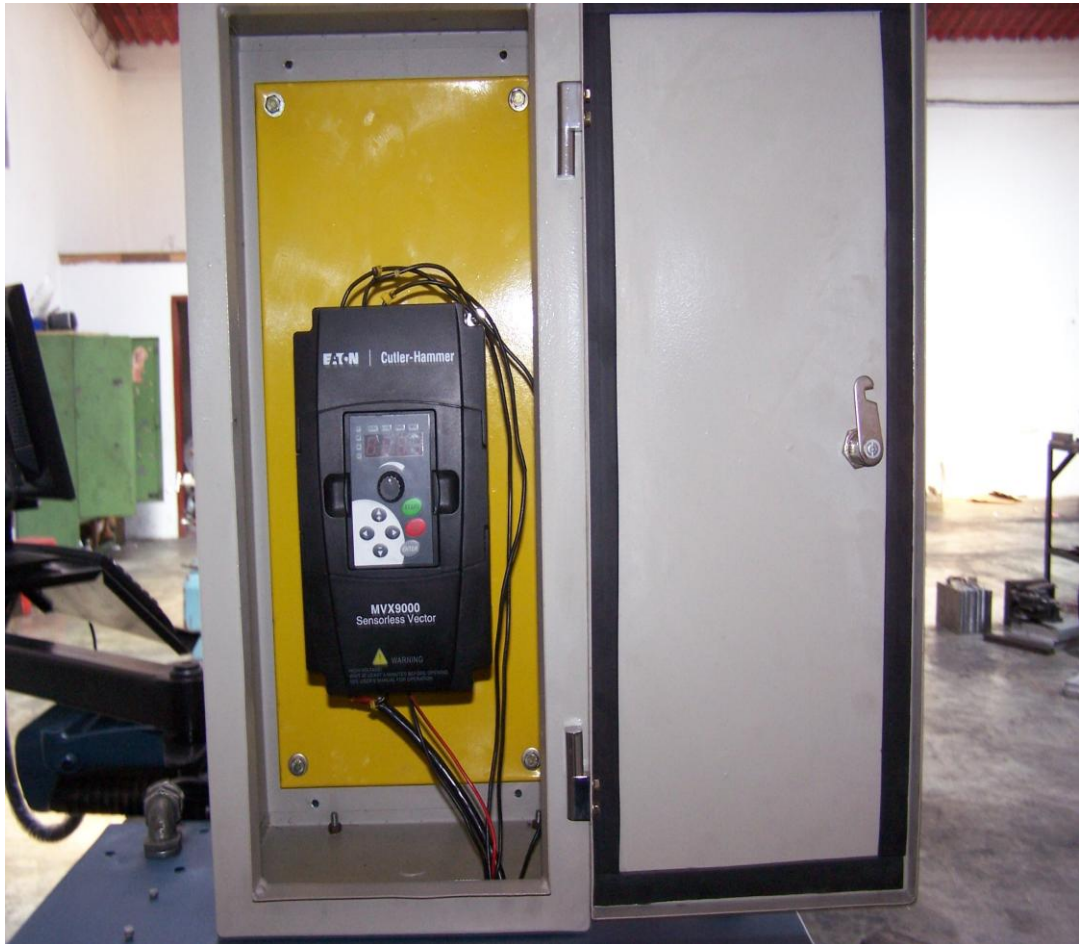
Variador de frecuencia marca Cutler Hammer
