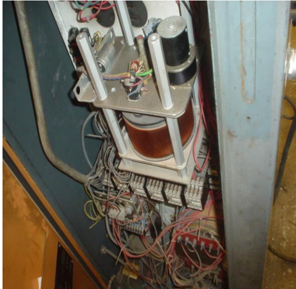
Caja de control Antigua
