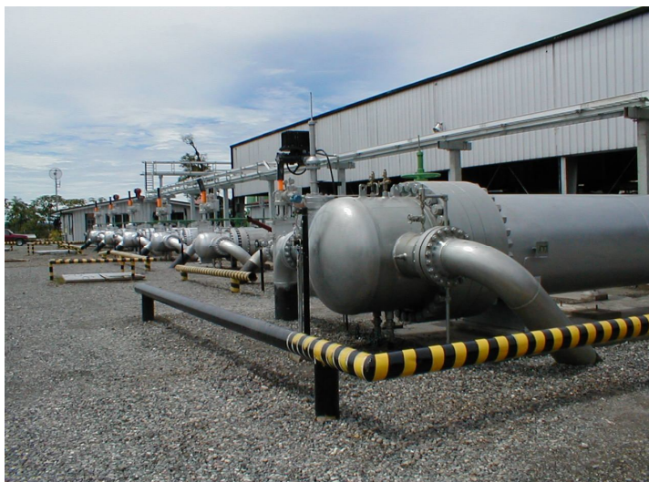
Fig. 1.6 Estación de bombeo "Lumbaqui"
