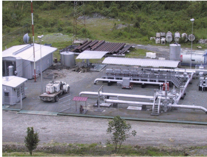
Fig. 1.13 Estación reductora de presión "Santo Domingo"
