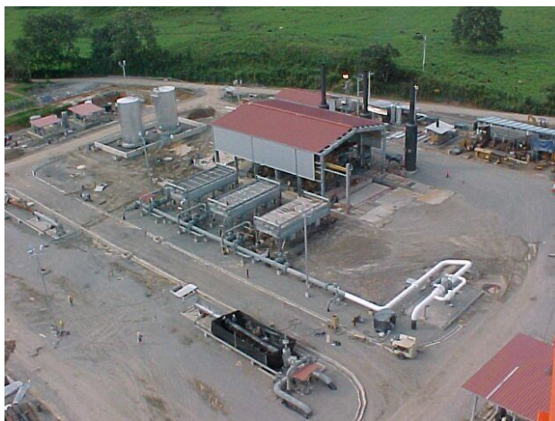
Fig. 1.14 Estación de rebombeo "Quinindé"
