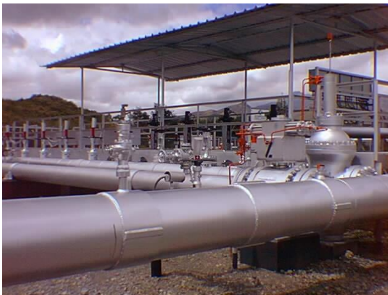
Fig. 1.10 Estación reductora de presión "San Juan"
