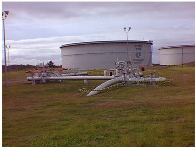
Fig. 1.3 Válvulas de llegada del crudo en Balao
