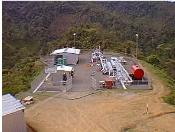
Fig. 1.11 Estación reductora de presión “Chiriboga”
