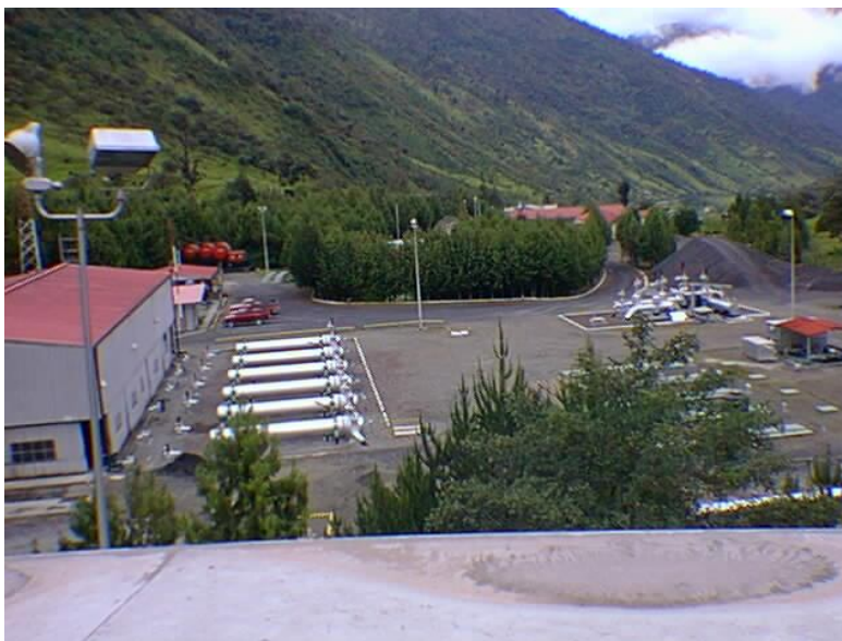
Fig. 1.9 Estación de rebombeo "Papallacta"
