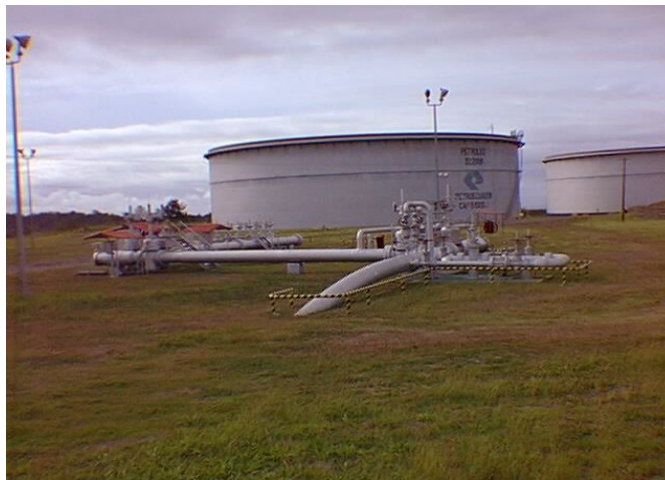
Fig. 1.15 Tanques y válvulas reductoras
