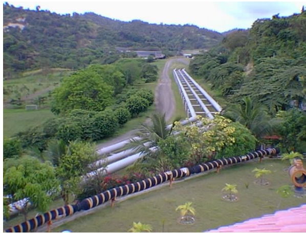
Fig. 1.16 Líneas de carga y deslastre
