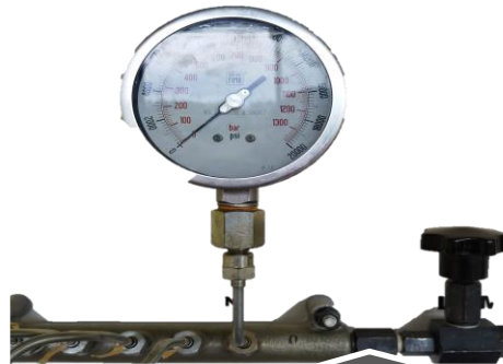
Línea de alta presión
