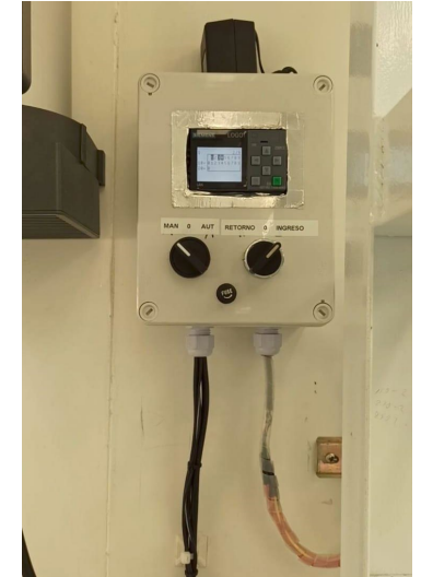
Sistema de Control PLC
