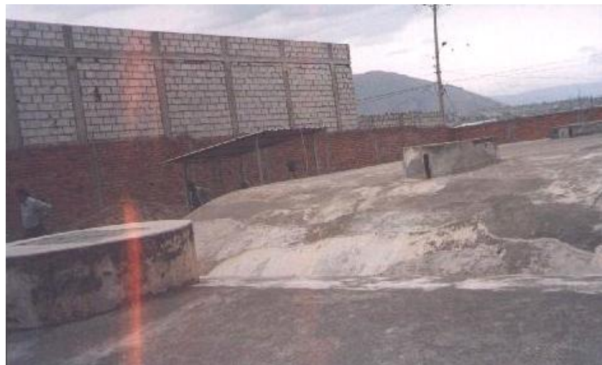
Tanques de reserva "El Calvario"
