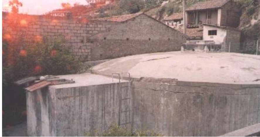
Tanque de reserva "San Felipe Bajo" (Tanque viejo)
