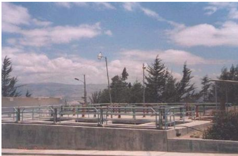
Filtros y canaletas de desinfección y clorificación del agua.
