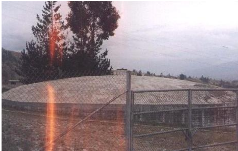
Tanque de reserva "San Martín"
