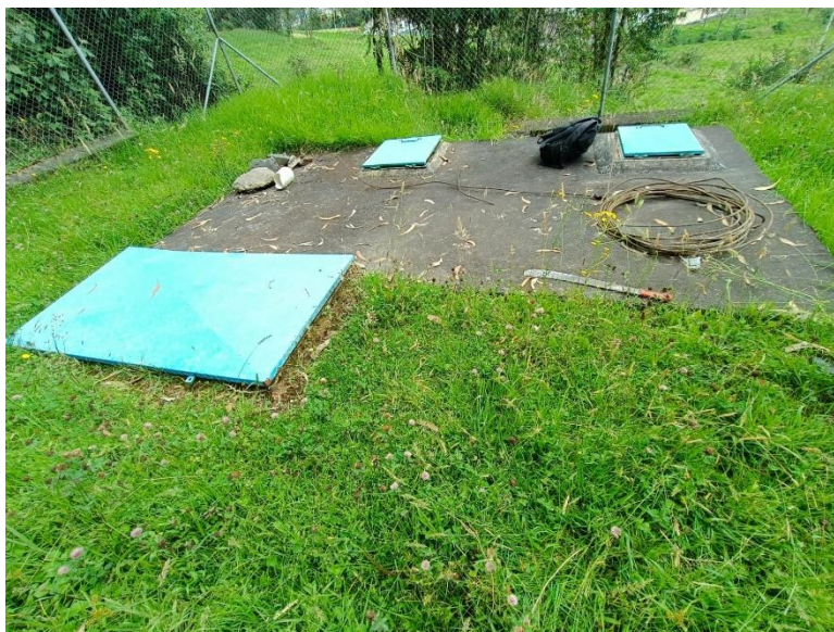
Primer tanque rompe presión
